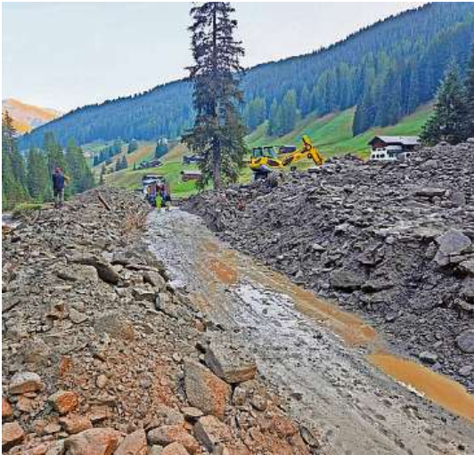
Aufräumarbeiten werden noch einige Tage dauern: Die Strasse ins Davoser Sertigtal ist vom Geschiebe befreit. (FOTO GEMEINDE DAVOS)
